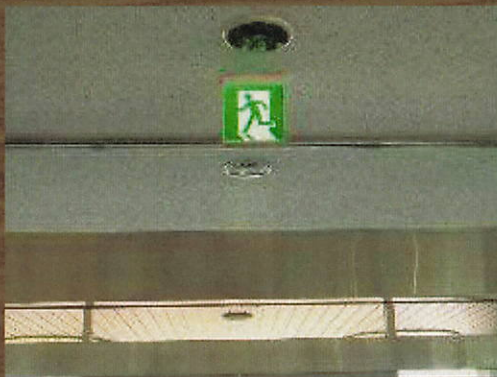
避難口誘導灯
