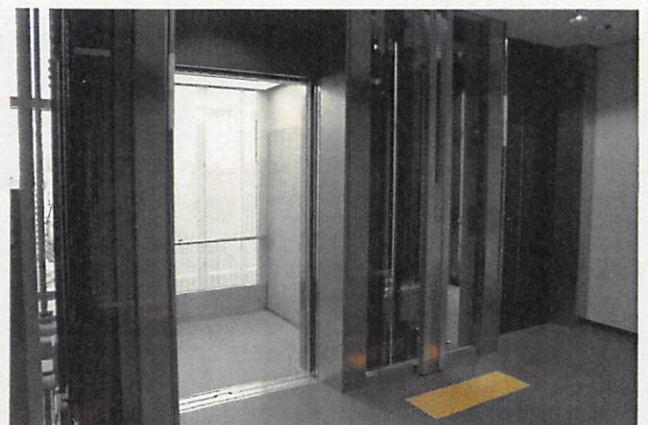
エレベーター
